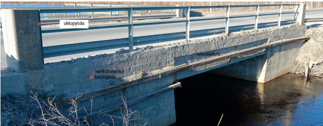
Kuva 8 Huonokuntoisen betonilaattasillan halkeilukuva (kuvassa on yksiaukkoinen ”teräsbetoninen laattasilta”).
